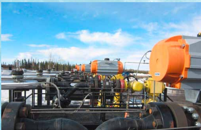
STARLINE-Kugelhähne mit Antrieben von AIR TORQUE regeln die Anbindung dieser Gasquelle am Horn River im Norden von British Columbia an das Pipelinesystem.
