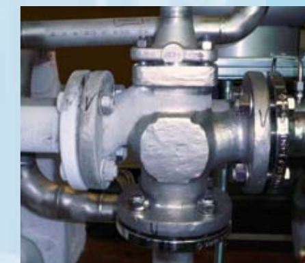
Frío extremo a la izquierda y calor extremo abajo. Esta válvula de tres vías debe resistir un gran estrés de temperaturas.
