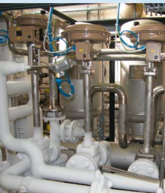
Lange Isolierteile schützen die Antriebe vor extremen Temperaturen in einer Prozesskühlanlage.
