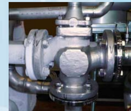
Links extrem kalt, unten extrem heiß – dieses Dreiwegeventil muss enorme Temperaturspannungen verkraften.
