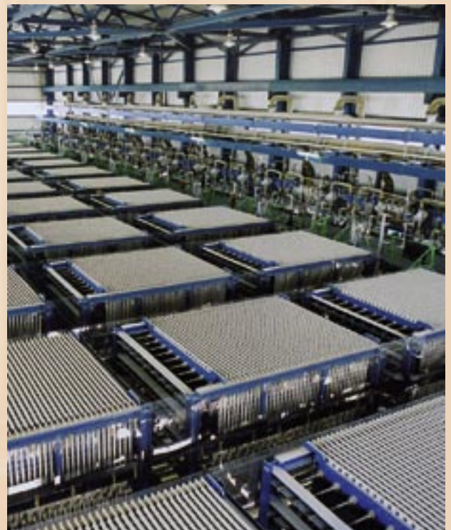
Bei der Chloralkali-Elektrolyse werden im Zellsaal einer Chlorfabrik große Mengen Wasserstoff freigesetzt.
