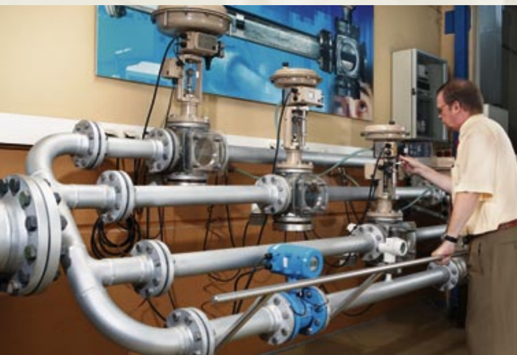
Test sul banco di collaudo relativo alla simulazione di condizioni del processo di funzionamento tra posizionatori con comunicazione bus, stazioni di controllo e sensori.
