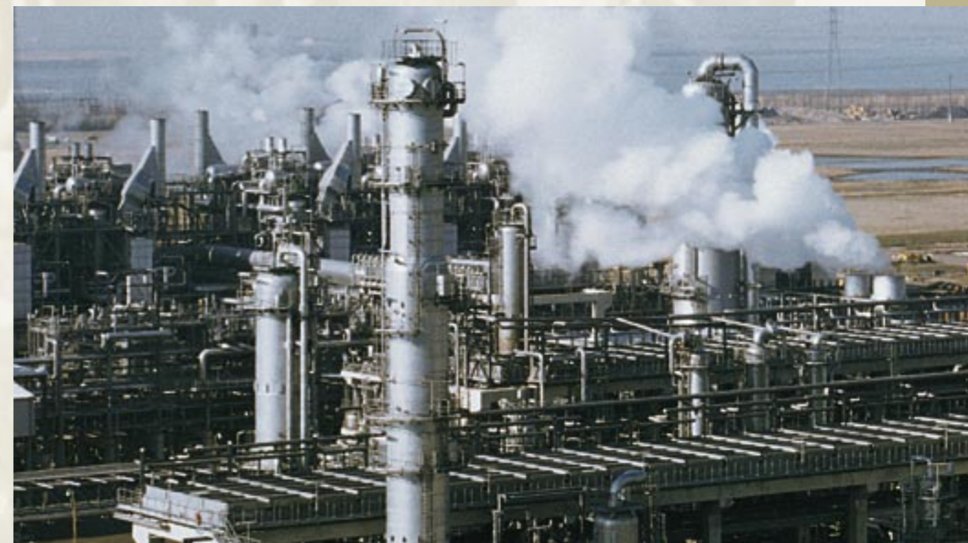
En el craquer de vapor más grande del mundo en Amberg están instaladas más de 1000 válvulas de control SAMSON que trabajan con temperaturas del medio entre -200 °C y +500 °C.
