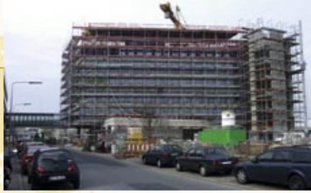
Diez meses más tarde: el armazón del edificio casi está terminado. Se puede reconocer una parte de la construcción de cristal.
