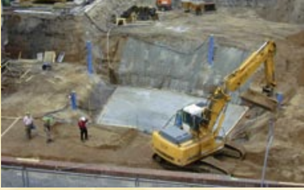
Beginn der Bauarbeiten am 17. Mai 2005. Das neue Bauvorhaben umfasst ein Bruttovolumen von gut 21.000 m 3 .
