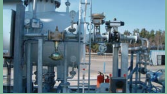
La Cool Sorption utilizza regolatori autoazionati, valvole di regolazione, posizionatori e valvole a farfalla SAMSON nei suoi impianti.
