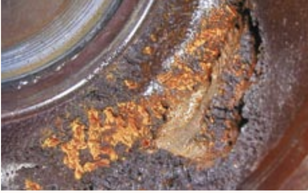
Corps de vanne érodé par la cavitation au niveau du pont de siège. L'érosion due à la cavitation peut provoquer une fuite vers l'extérieur.
