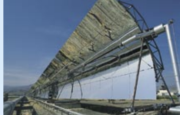
Collettori parabolici presso la Plataforma Solar de Almería.
