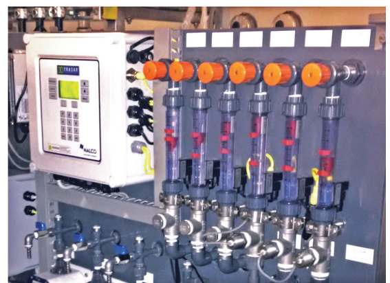
Wasseraufbereitungsanlage in der Automobilindustrie
