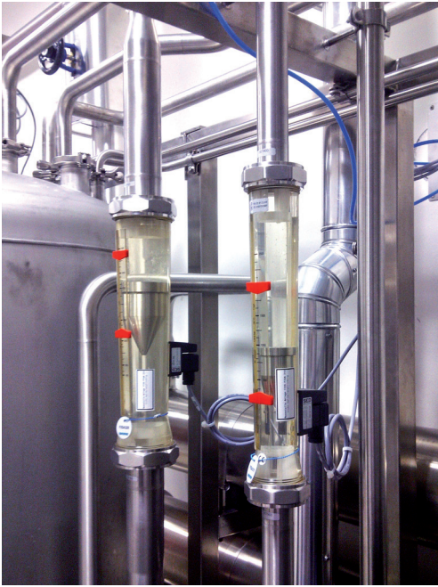
Überwachung von Konzentrat und Rezirkulation einer Umkehrosiose Wasseraufbereitungsanlage
