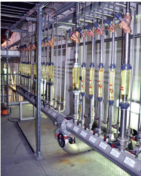
Kühlwasser-Verteilung einer Glasschmelze-Anlage
