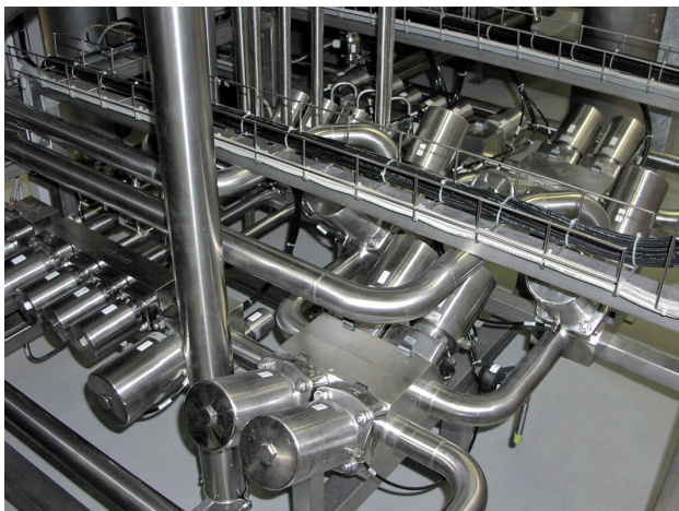
Kompakte Abfülleinheit mit kundenspezifisch gefertigten Mehrwegeventilblöcken
