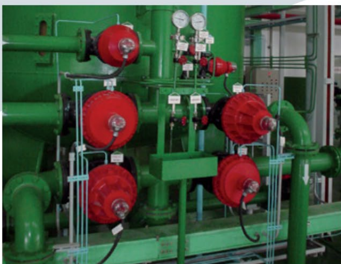
燃煤化学厂除盐水
