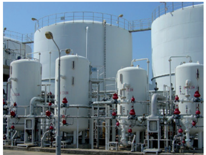
Wasserentsalzungsanlage in der Petrochemie
